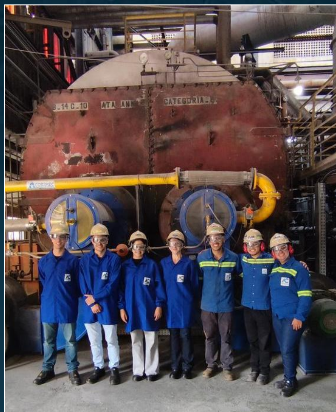
Foto 15. SGI, Comunicação e Operação na Caldeira a gás durante visita técnica.
